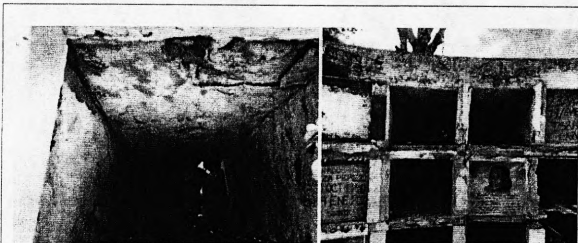
Figura 3. Estado de deterioro de modulo 7 de cementerio harmony hall para demolición
